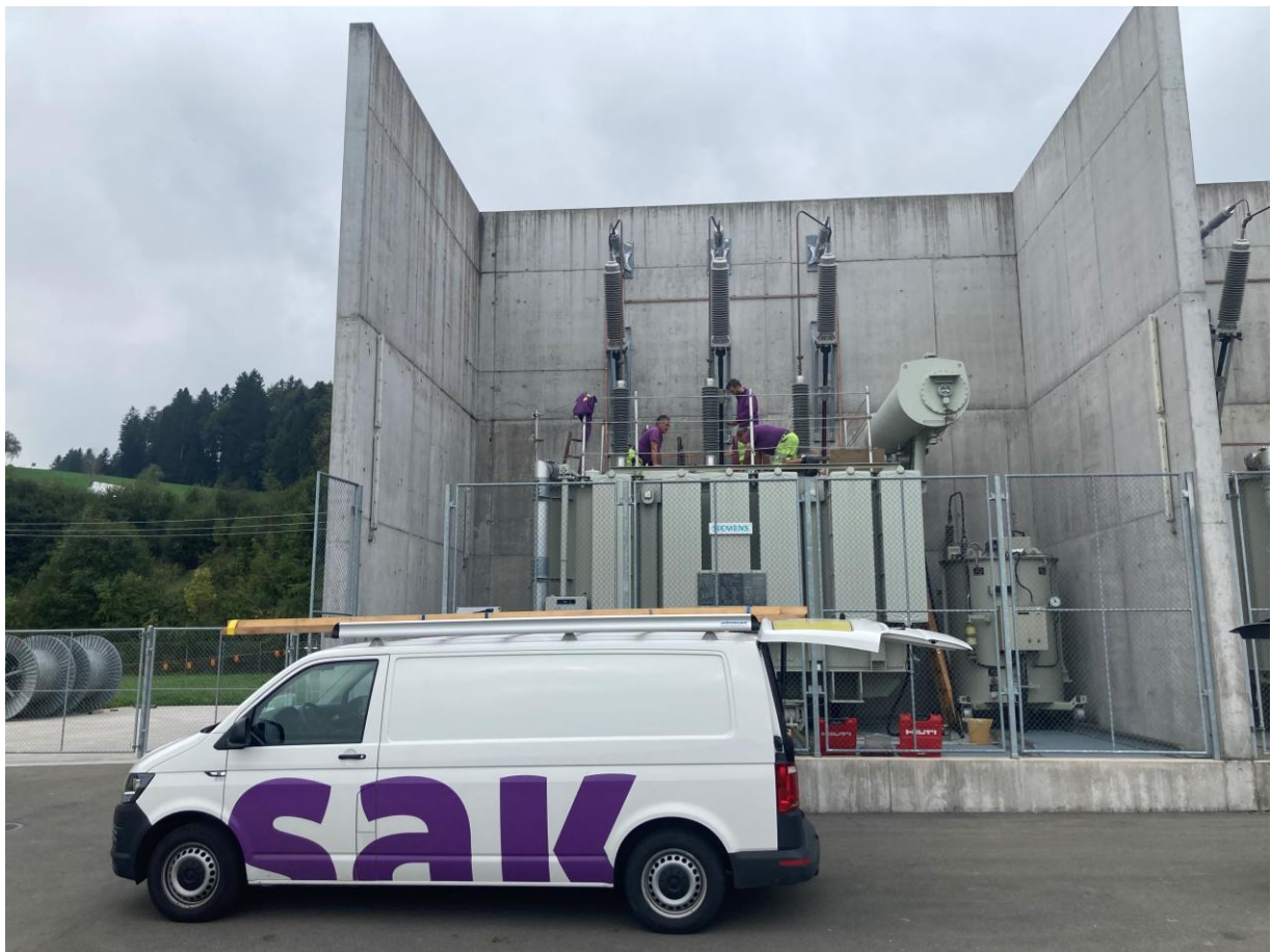
Laschen umstecken am Transformator im Unterwerk Wattwil (Bild SAK).
