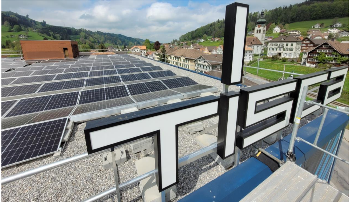
Die neue SAK Photovoltaikanlage, installiert auf dem Dach des Tisca Gebäudes in Bühler (Bild: SAK).
