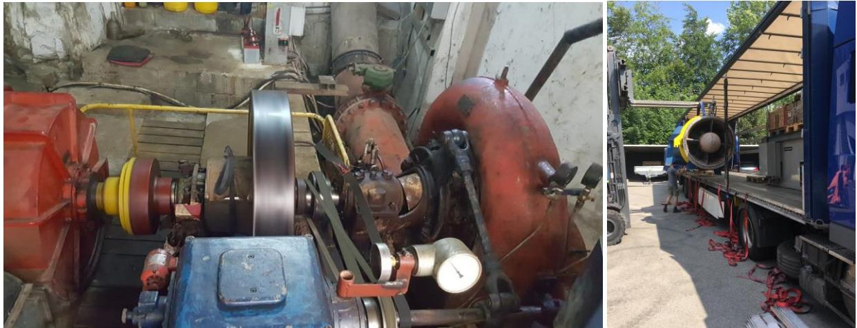
Die zwei alten Turbinen vom Wasserkraftwerk Schils im Einsatz für das Hilfswerk «Brot für die Welt» im afrikanischen Kongo (Bild: SAK).
