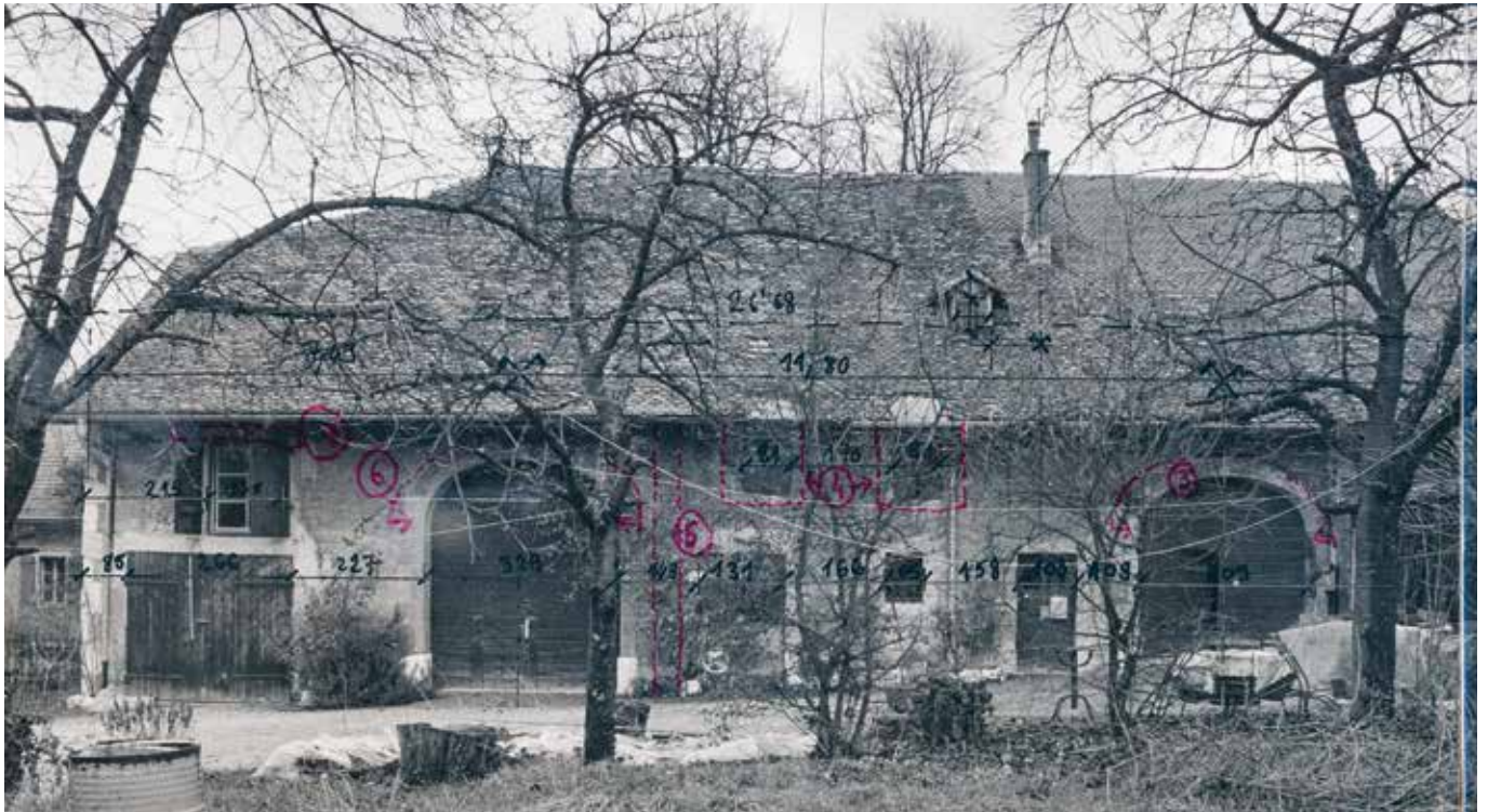
9 Die Schauseite des Mehrzweckgebäudes aus Lancy GE wies mehrere nachträgliche Eingriffe auf. Ansicht ehem. Südwest. Fotogrammetrische Bauaufnahme, 1984 (FLM AltA 111).
