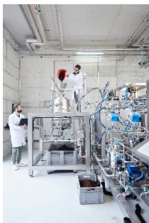
Installation pilote d'extraction à Bienne. Source : BFH
