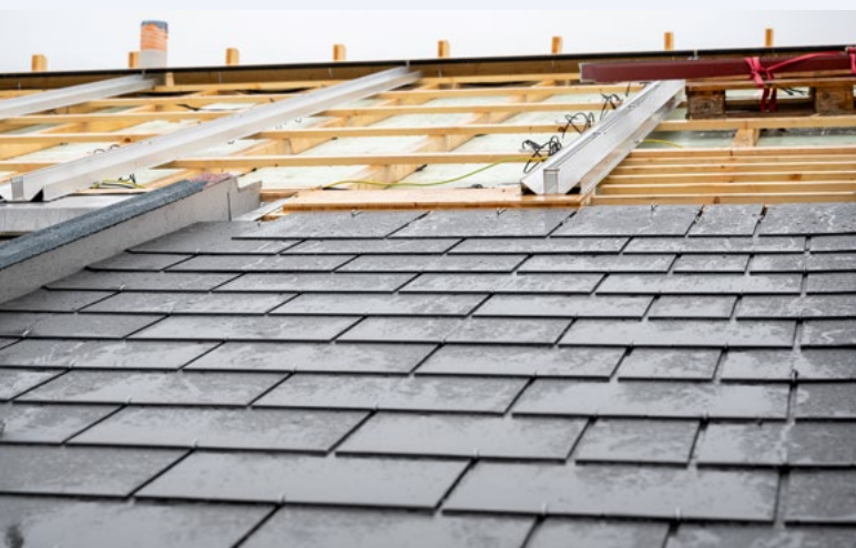
Des modules photovoltaïques sont installés sur le toit de la résidence pour personnes âgées afin d'alimenter le bâtiment en énergie solaire.
