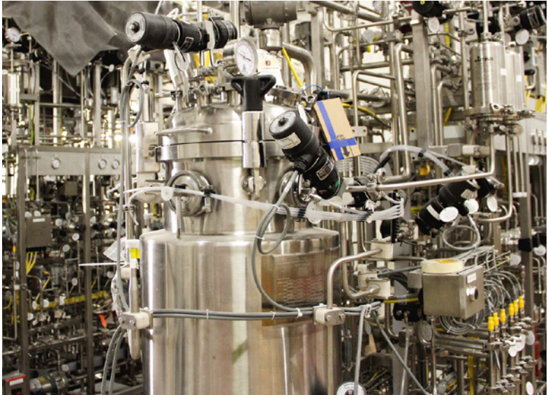
Das Innere der Produktionsanlage
