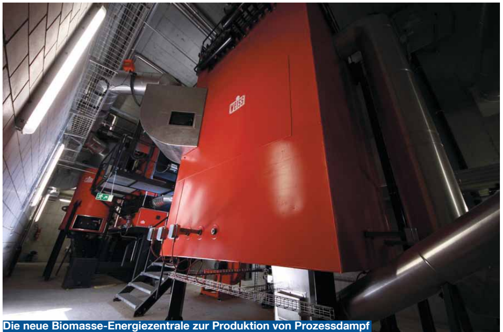
Die neue Biomasse-Energiezentrale zur Produktion von Prozessdampf
