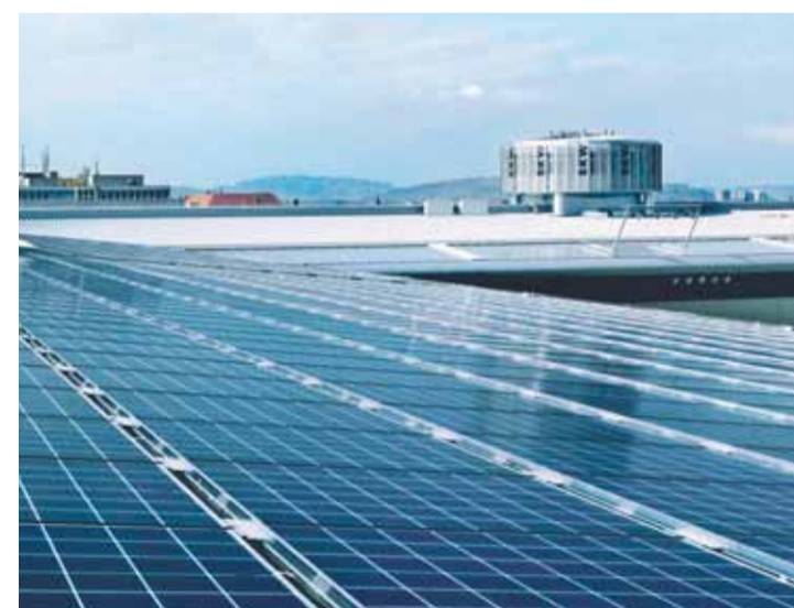
Centrale solaire du Stade Suisse
