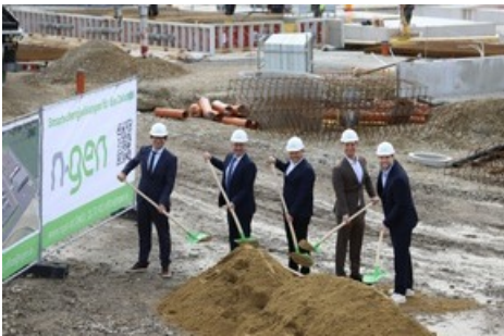
Die ersten Fundamente sind bereits gegossen beim Spatenstich zu einer Europas größten, systemdienlichen Energiespeicheranlagen.
