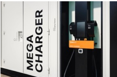
Detailansicht der Bedienoberfläche: Links der Ladepunkt mit MCS-Stecker für Megawatt-Laden, rechts der Ladepunkt mit dem etablierten CCS Typ-2-Stecker. / © Designwerk Technologies AG
