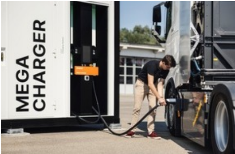
Der Projektleiter der Designwerk Technologies AG verbindet den MCS-Ladestecker mit dem Prototypen-LKW, bevor er den Ladevorgang am Mega Charger startet. / © Designwerk Technologies AG
