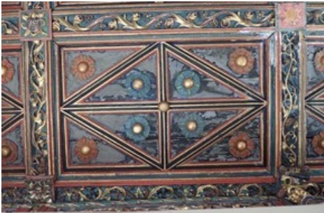
Kassettendecke Fürstenzimmer vor der Restaurierung mit Wasserschäden, Flecken
