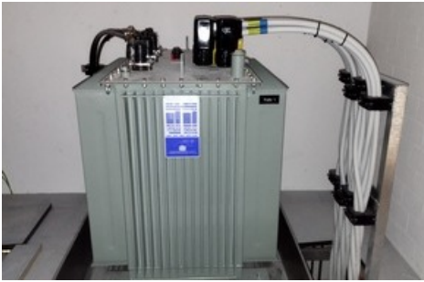
Mittelspannungs-Verteiltransformatoren der Rauscher & Stoecklin AG (Bild: SAK).
