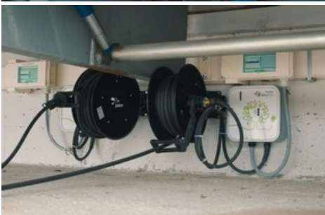
Das Laden an der Rampe erfolgt über das 14 m lange Kabel. / Juice Technology AG
