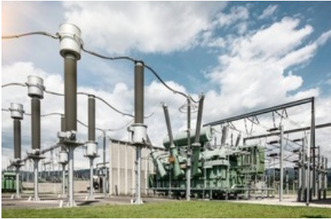
Unterstation Bassecourt. Foto: Philipp Zinniker
