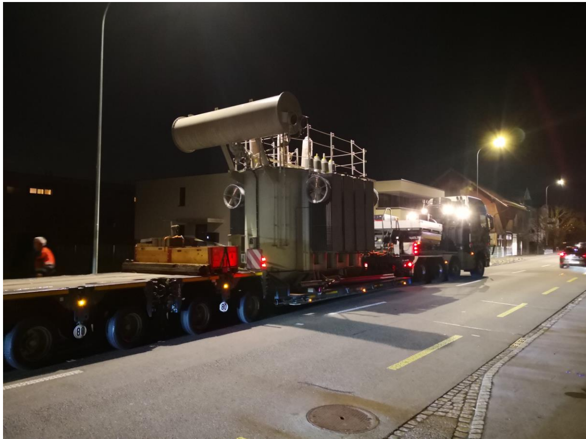
Vergangene Woche wurde an das SAK Unterwerk Widnau ein neuer 110/20 kV Transformator geliefert (Bild: SAK).
