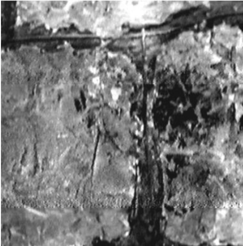
NIR 1: Hochauflösende NIR Aufnahme aus einem Tunnelgewölbe zum Kartieren von Rissen
